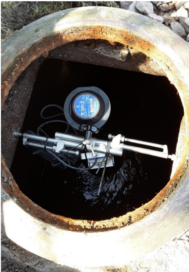
Kuva 22. Kaivoon asennettu ultraäänimittauslaitteisto.
